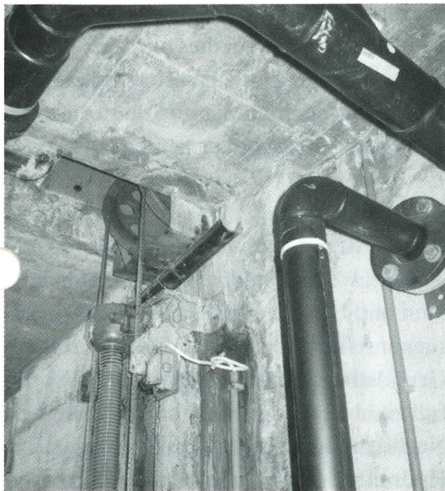
Undichtigkeiten im Hubbodenbereich
