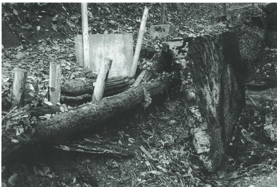
Vor der Sanierung: Die Betonstützmauern sind unterspült und teilweise weggeschwemmt, der Fussweg provisorisch mit Holz gesichert.
