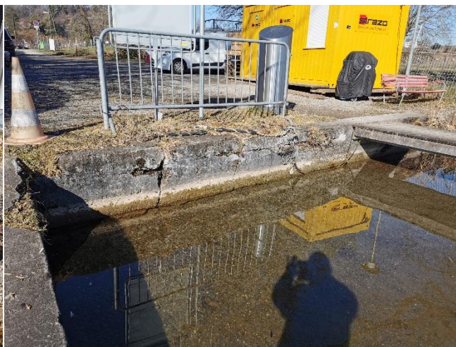
Abbildung 8: Risse und Abplatzungen Ufermauer
