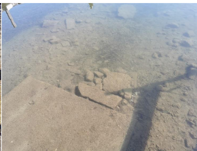
Abbildung 6: Ungenügende Abmessungen Rampe
