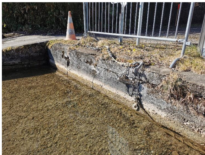
Abbildung 7: Ausbrüche und Bewuchs Ufermauer
