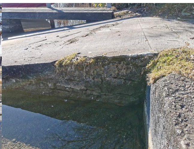
Abbildung 4: Abplatzungen Betonplatte und offene Fugen Mauerwerk
