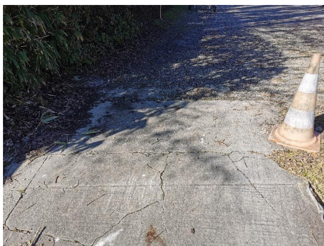
Abbildung 5: Risse und Scherbenbildung Betonplatte
